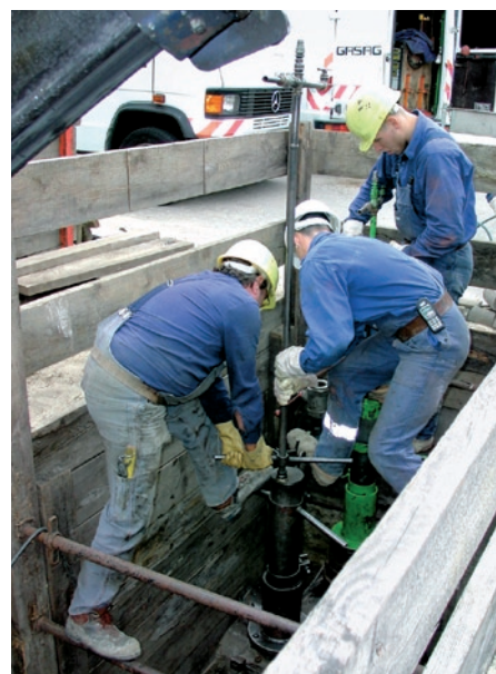
Gasag Berlin. Bei Störungen müssen Gasversorger innerhalb von 30 Min. vor Ort sein. Sie werden über Tetra-Funk und eCityruf-Pager alarmiert.
